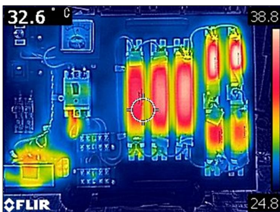
配電盤内の発熱監視 (MSX画像)
