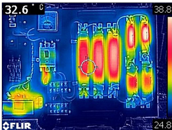
配電盤内の発熱監視 (MSX画像)
