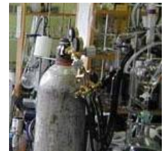
可燃性ガスの 使用場所監視
